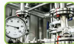
Instalaciones Generales & de Procesos
