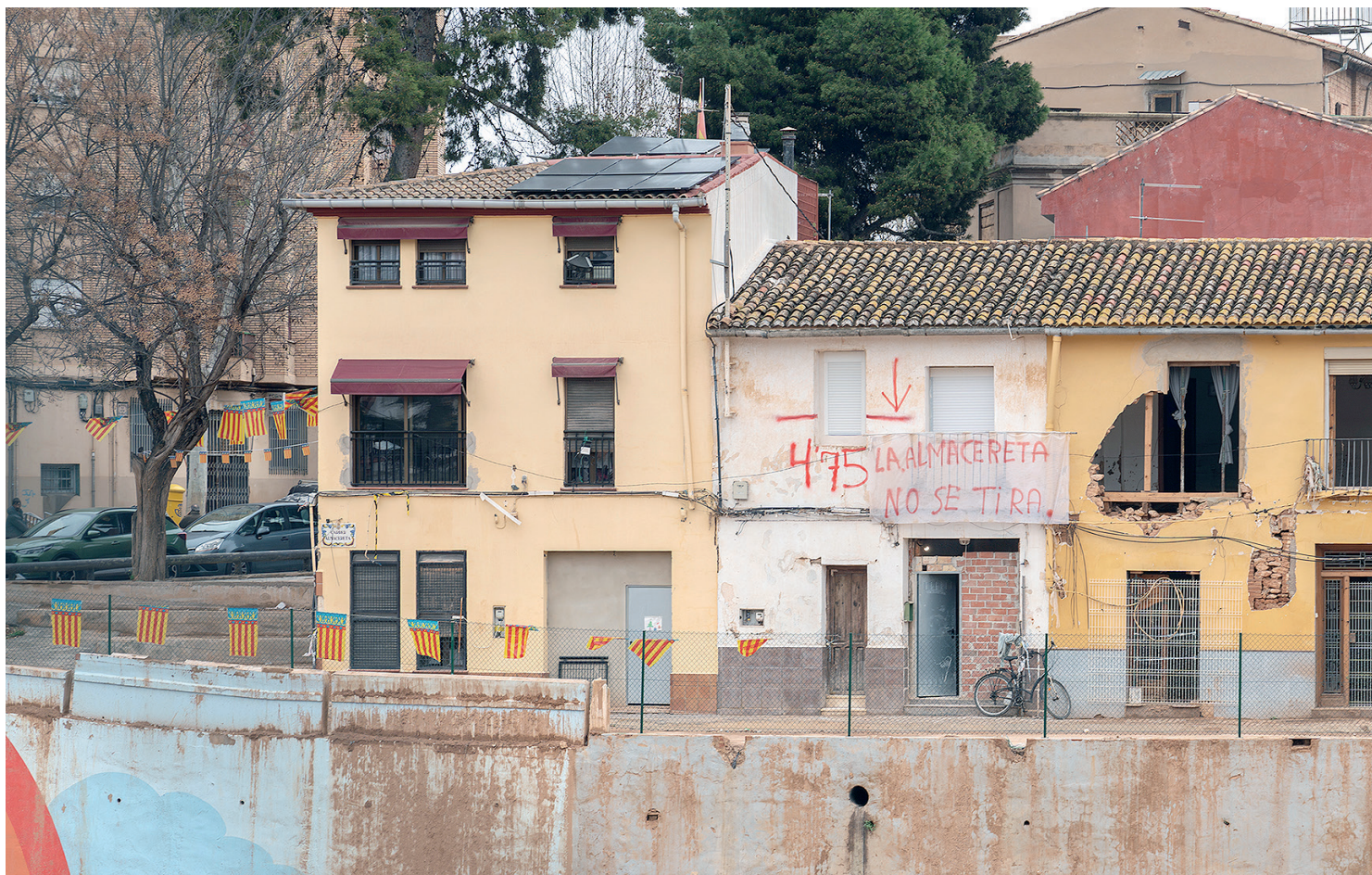
Casas afectadas en la calle Almassereta de Picanya. Una inscripción recuerda el nivel al que llegó el agua, 4,75 m, y la reivindicación de los vecinos para que no se derribe toda la zona.
