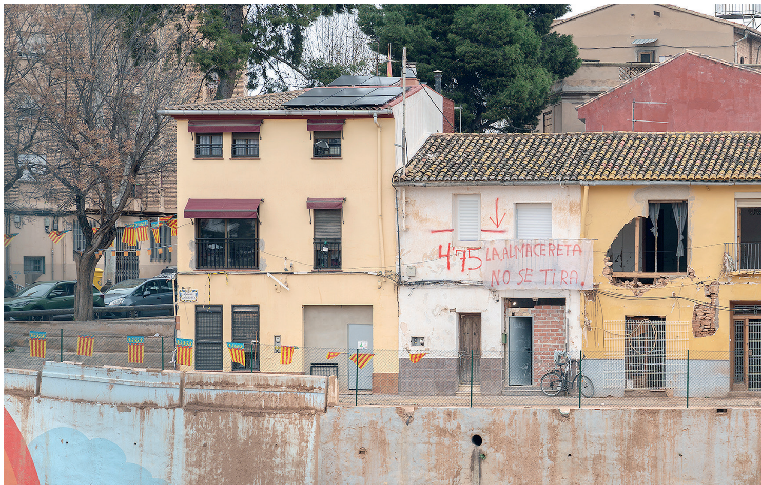
Cases afectades al carrer Almassereta de Picanya. Una inscripció recorda el nivell a què va arribar l’aigua, 4,75 m, i la reivindicació dels veïns perquè no s’enderroqui tota la zona.
