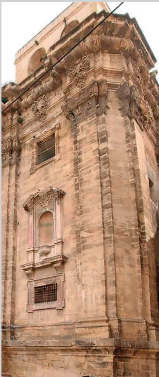
Estado actual de la fachada de la catedral de Tortosa. (Obispado Tortosa)
