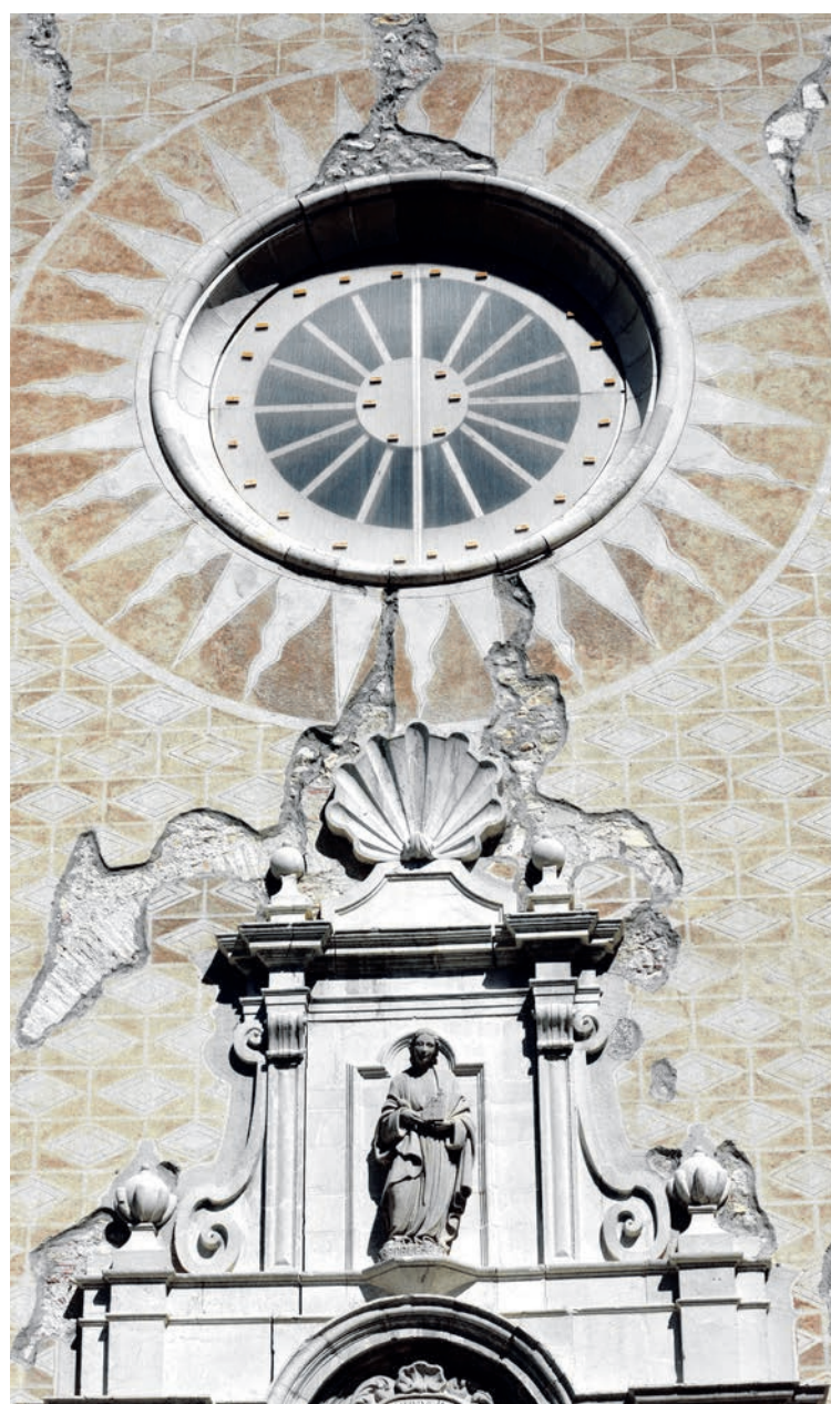
Las grietas han obligado a cerrar el templo. / Luis Milián
