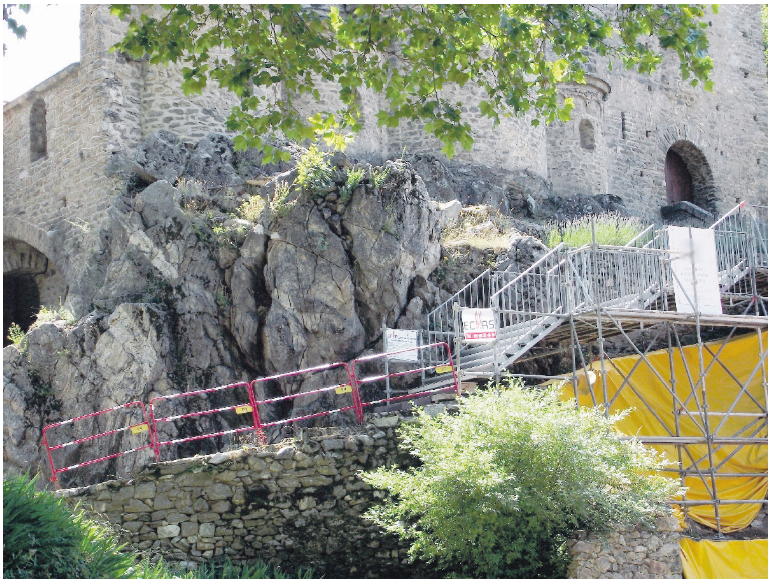
El monestir necessita endegar obres de millora.
