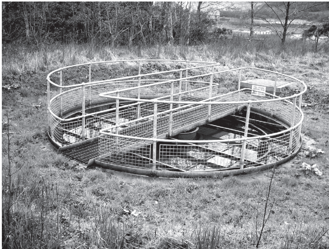
Tanque de sedimentación secundaria en una planta de tratamiento de aguas residuales en zona rural.
