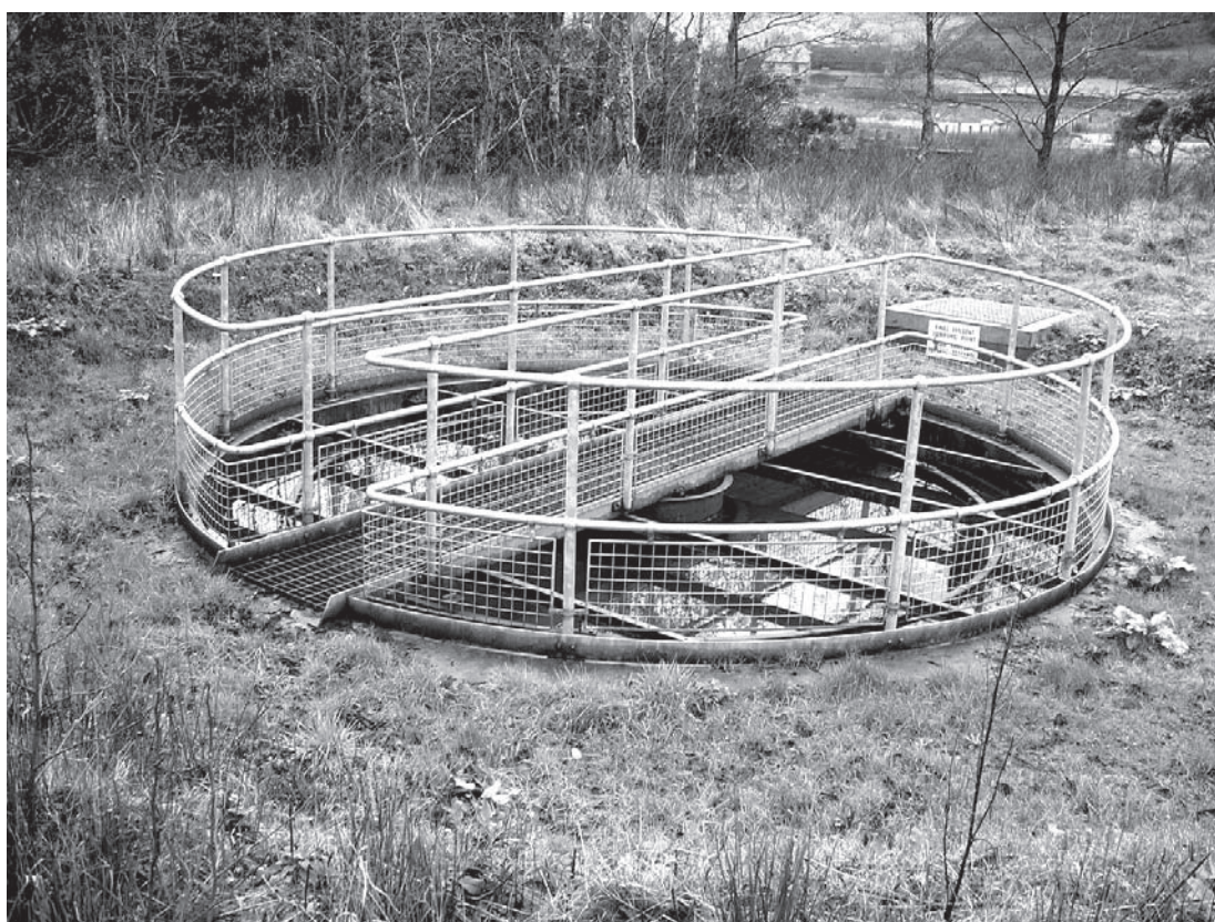
Tanc de sedimentació secundària d'una planta de tractament d'aigües residuals en una zona rural.
