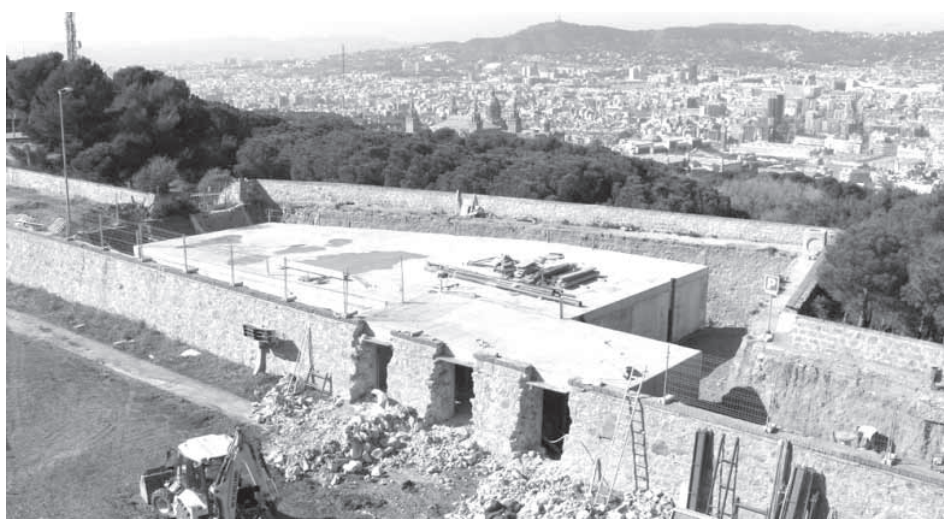
El castell de Montjuïc és un dels conjunts arquitectònics en perill actualment a Barcelona.
