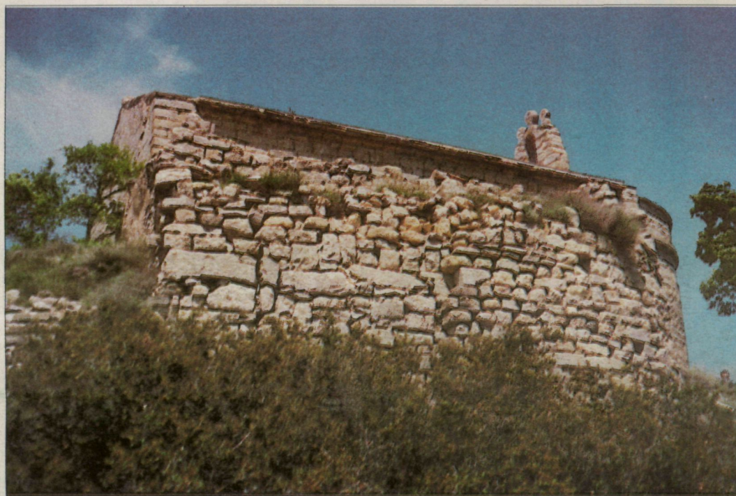
El mur sud de l'ermita s'ha desplaçat en els últims anys fins a 3 cm.
